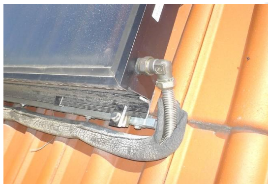
Dégradation du calorifuge exposé au soleil
